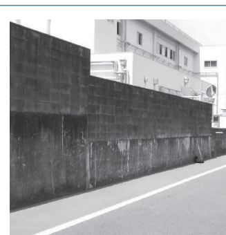
小中学校の危険ブロック塀の 早期撤去が望まれる
